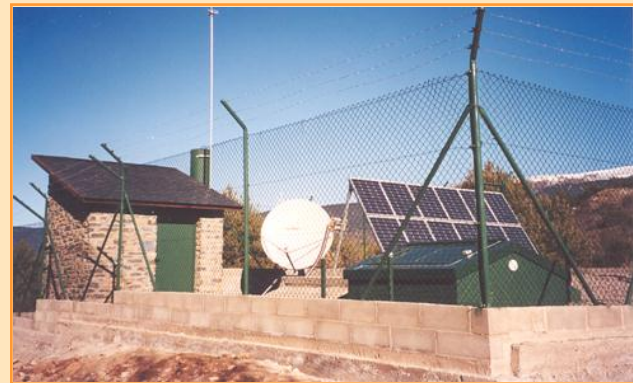
Estació sísmica de Llívia Transmissió per satèl·lit, sistema VSAT.
